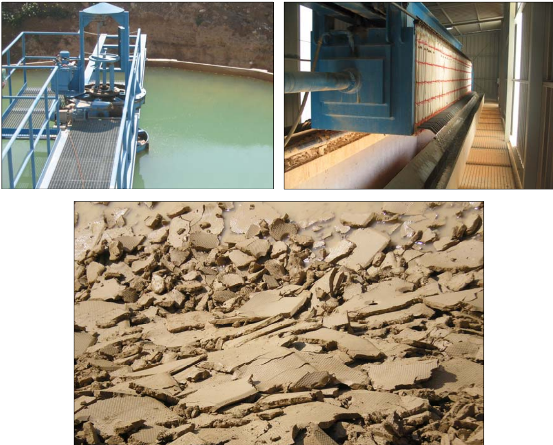
Fig. 5.17.- Decantador/espesador, filtro prensa y residuos secos de lodos del filtrado (ÁRIDOS BLESA, S.A.)
