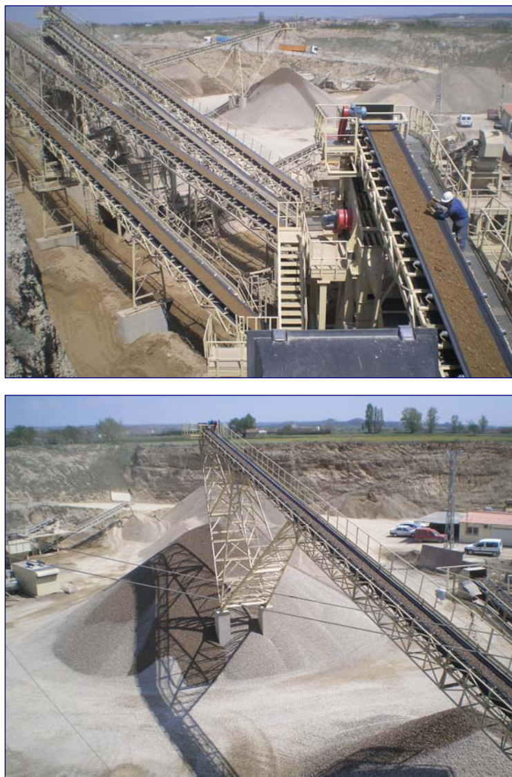
Fig. 4.7.- Instalaciones de lavado y clasificación de áridos. ÁRIDOS BLESA, S.A.
