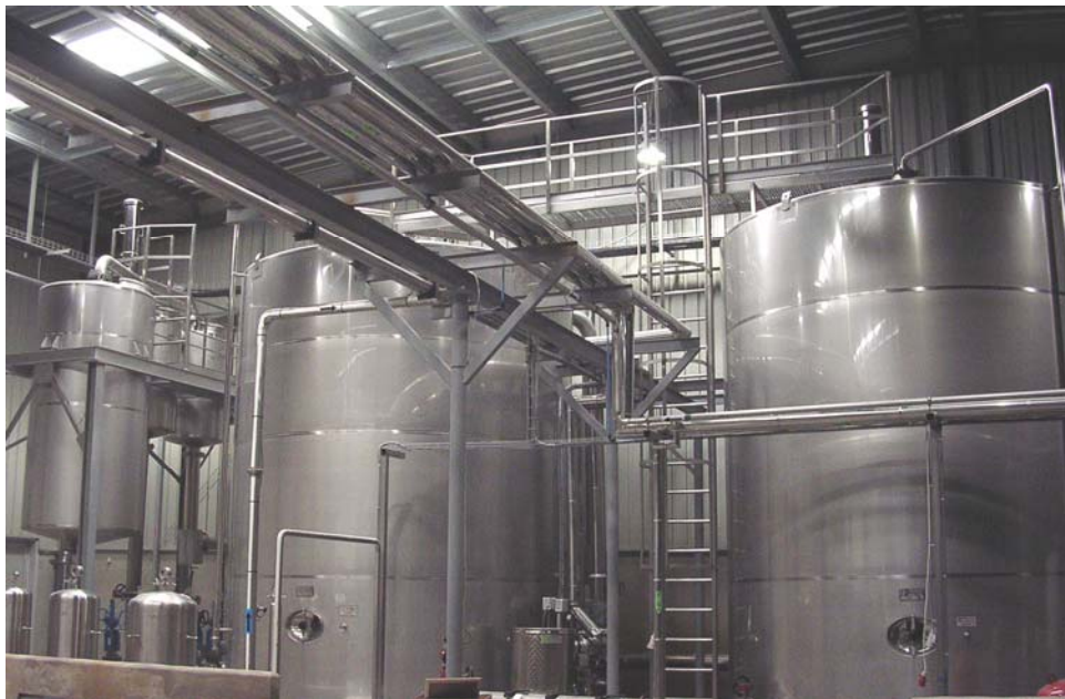
Fig. 3.51.- Instalaciones (planta de Bronchales)
