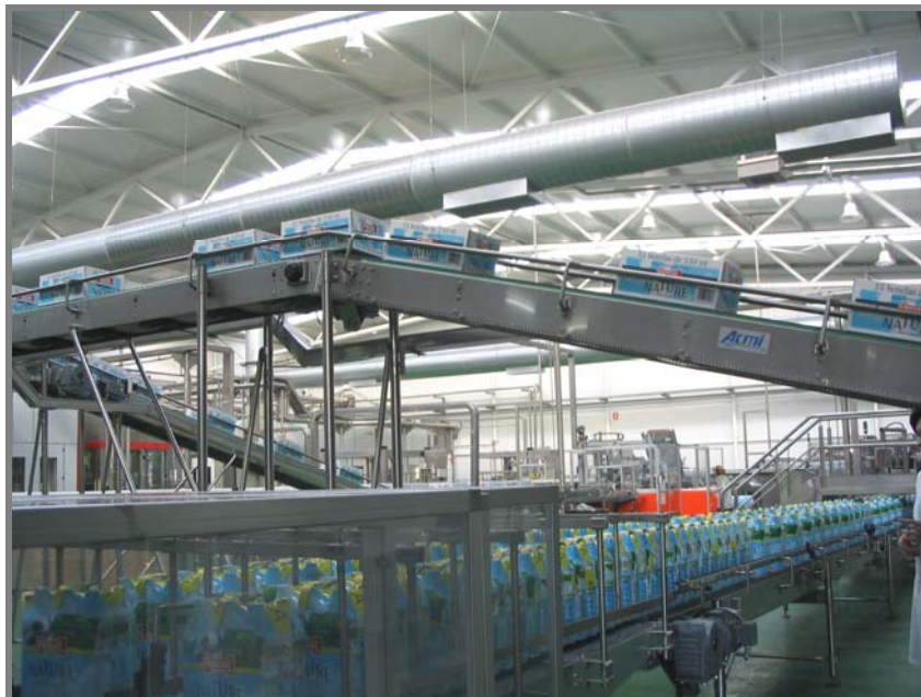
Fig. 3.55.- Instalaciones de la planta de Ribagorza
