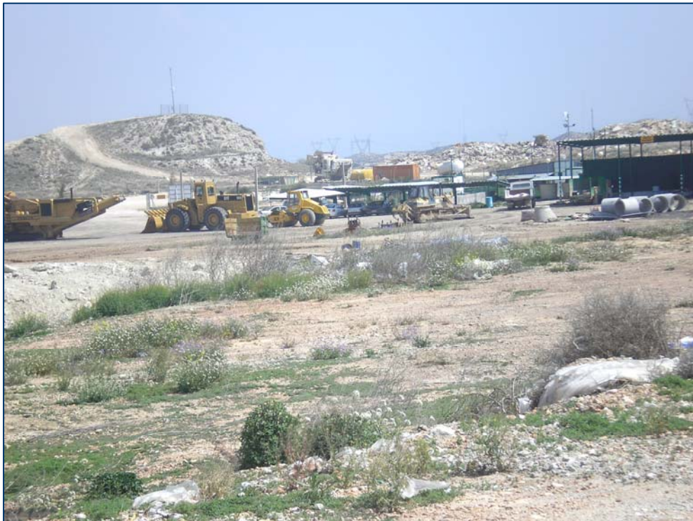
Fig. 4.10.- Instalaciones de Gestión de residuos inertes y no peligrosos "Vertedero las Canteras", Torrero, Zaragoza. SUDISMIN
