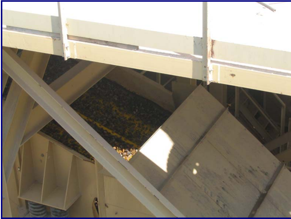
Fig. 5.13.- Recubrimiento de la maquinaria de tratamiento, para reducción del ruido por impactos
