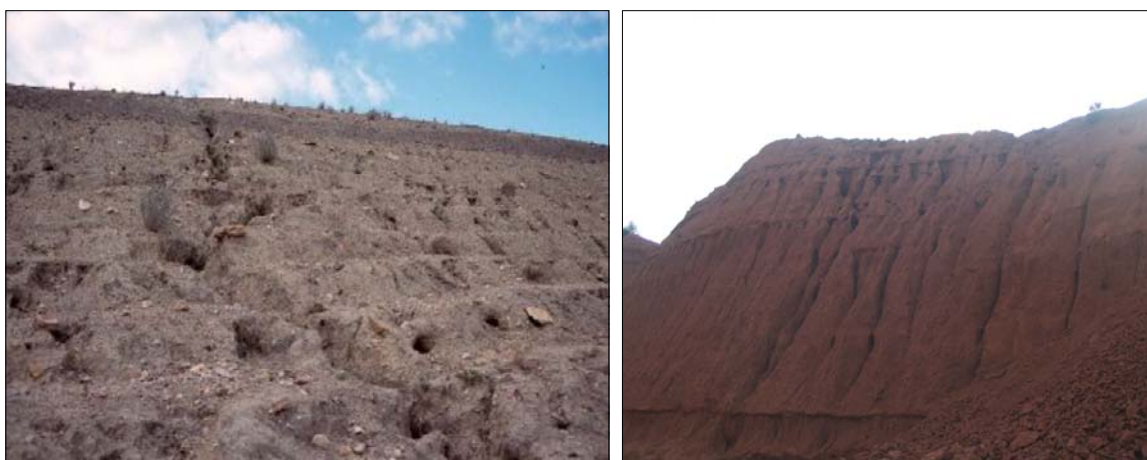
Fig. 5.25.- Profusi3n de regueros, cárcavas y fenómenos de subfluji3n, en taludes resultantes de actividades mineras
